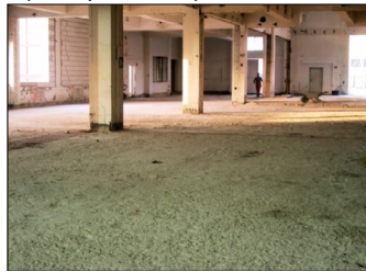
б) Шорстка поверхня плити
