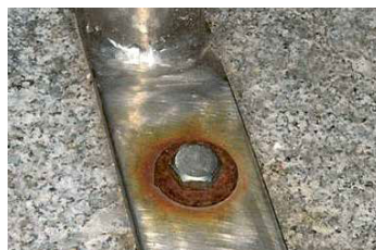
б) Сильна корозія оцинкованої шайби з вуглецевої сталі
